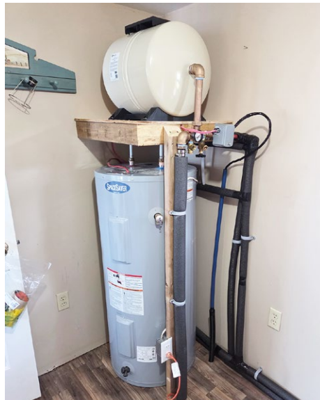
Une installation réalisée par Acadia Plumbing Solutions, comprenant un chauffe-eau, un réservoir de pression et la tuyauterie du système d'eau.
